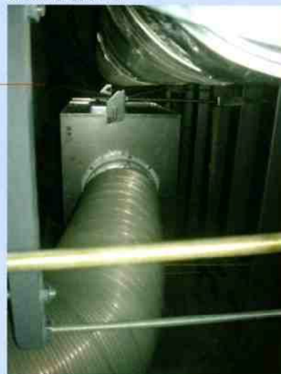
外気排出専用ダクト
